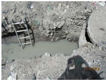
Image H3c. Possible rupture d'un tuyau ; eau stagnante sans écoulement ; contamination chimique possible.
