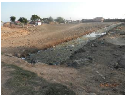
Image H3e. Drainage ouvert sans écoulement.
